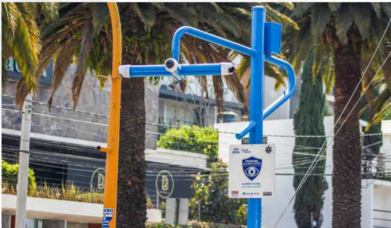
Cámaras de vigilancia
