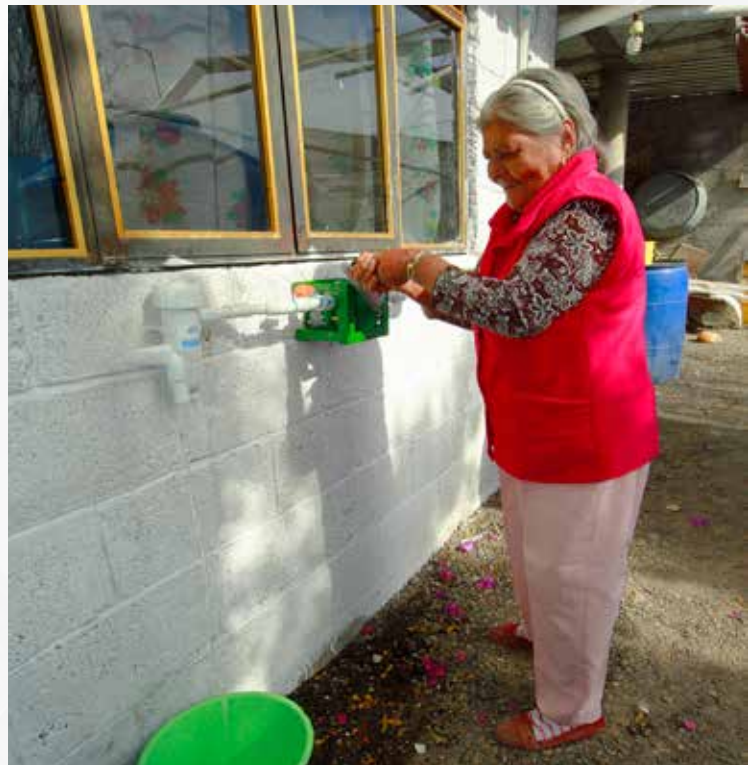
Sistema de captación de agua pluvial
